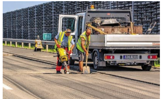
Der Zustand der Infrastruktur wird bemängelt
